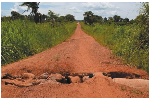
Cette buse n'a pas résisté à la disparition de la couche de roulement et cette piste, par ailleurs en relativement bon état, n'est plus passable. Un petit radier en béton aurait obligé les véhicules à ralentir mais serait encore là malgré l'absence d'entretien. 12
