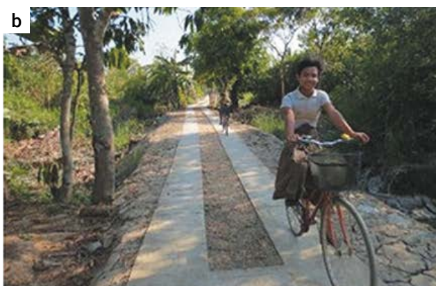
Une ITR adaptée : (a) état avant travaux, (b) un an après la fin des travaux.
